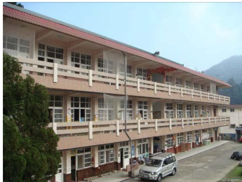
舊教學大樓耐震度不足
